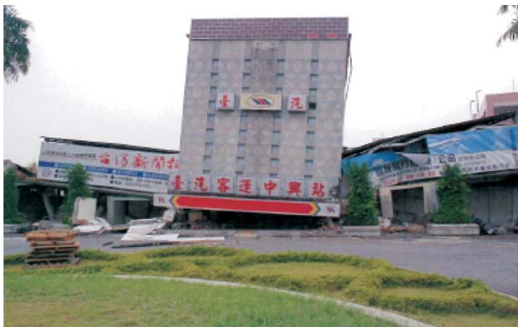
照片一 地震造成結構物倒塌(樑柱破壞)
