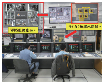
▲圖 1. 石化工廠 VFDS 監控照片
