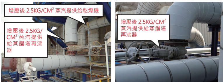
▲圖 5 將增壓過後的 2.5KG/CM 2 蒸汽提供給蒸餾塔再沸器與乾燥機加熱使用，取代部分 4.5KG/CM 2 蒸汽使用，將 2KG/CM 2 蒸氣全數去化。
