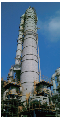
▲C202 乙苯循環塔
