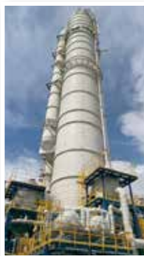
▲C202 乙苯循環塔
