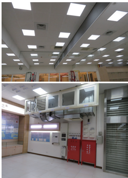
圖 9 排煙設備教學區
