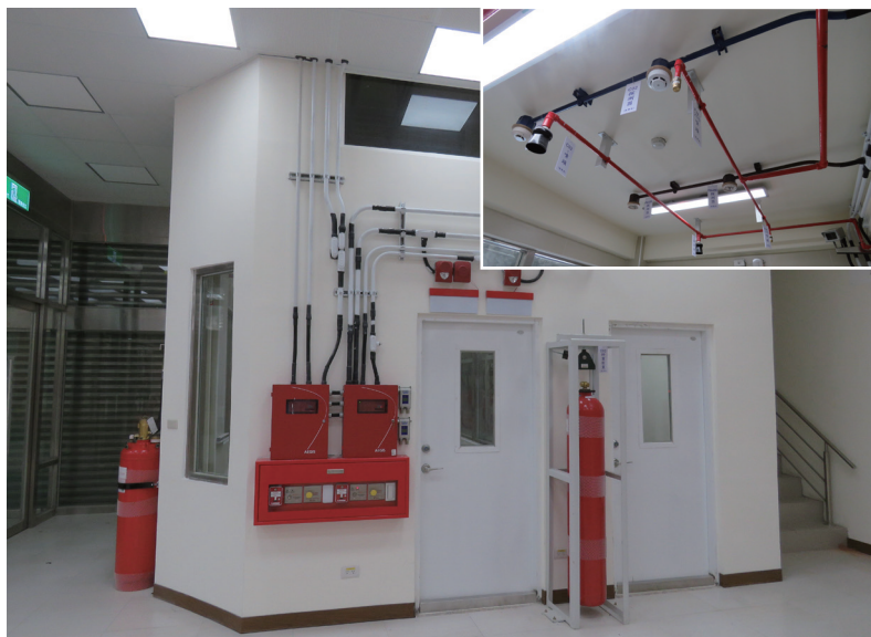
圖 6 氣體滅火設備教學區
